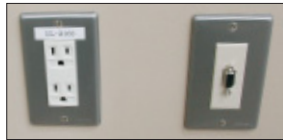
▲PC入力コンセント(右)を教室に設置することで、PCを教室に常設する必要がなく、セキュリティの確保にも役立っている。
