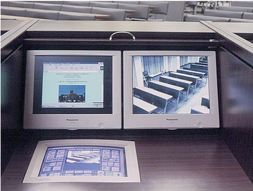
さまざまなAV機器の制御は、液晶タッチパネルに触れるだけでコントロールが可能です
