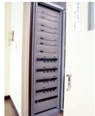
経済学部2号館の機器ラック
